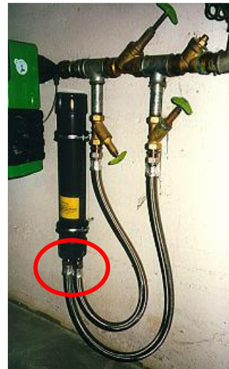
Der GIE-Wasser-Aktivator installiert unter der Wasserleitung mit Anschlüssen nach unten
